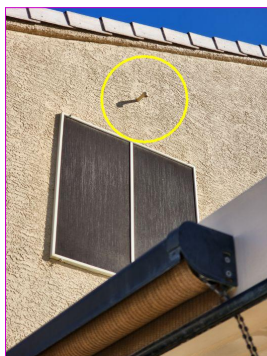
CENTRAL AIR CONDITIONER Condensate Disposal
