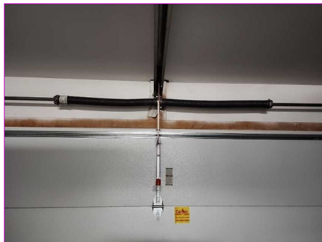
OVERHEAD GARAGE DOOR Door Springs
