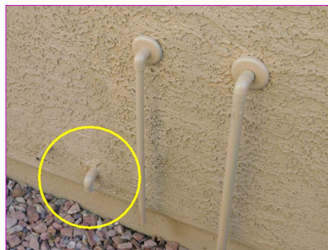
CENTRAL AIR CONDITIONER Condensate Disposal
